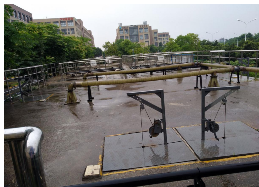
园区污水处理站
